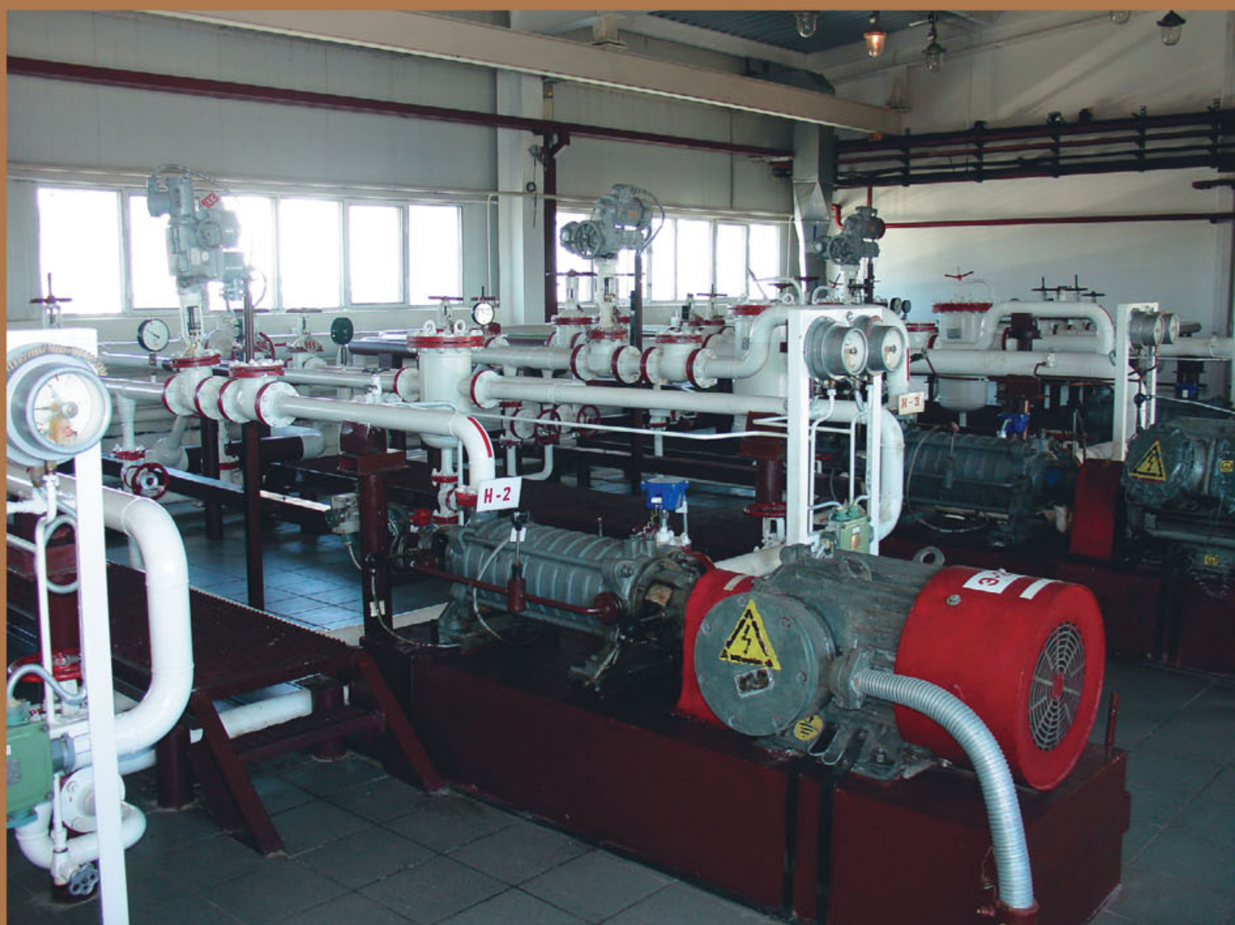
На дожимной насосной станции. 2006 год
